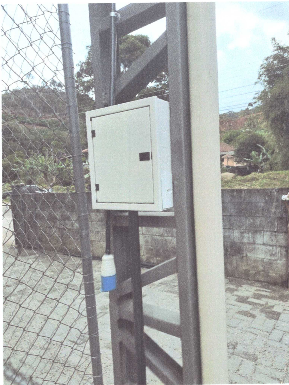
QUADRO DE ENERGIA E TOMADA ELETRICA
